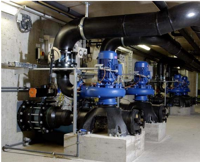
Bild 13: 4 Rohwasserpumpen an den Schwallwasserbehältern
