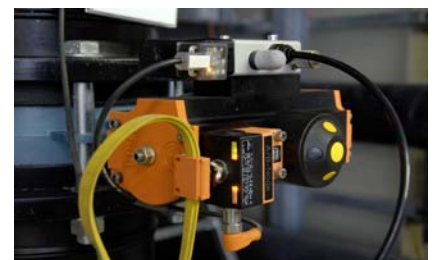
Bild 8: Filtratwasserleitung mit T5-Anschaltung
