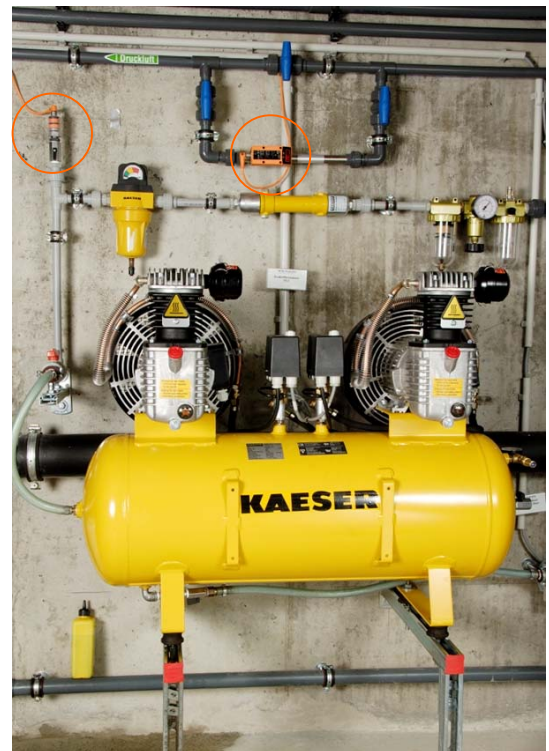
Bild 10: Druckluftherzeugung via Doppelkompressor mit Druckschalter PK6524 und Druckluftzähler SD6000
