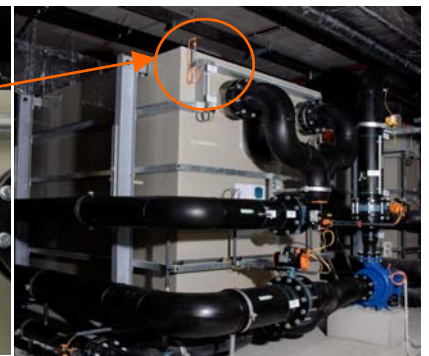
Bild 4: Filteranlage von Firma WTA mit Überlaufmeldung
