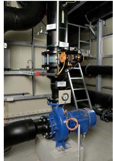
Bild 14: Filtratpumpen an den Filtern
