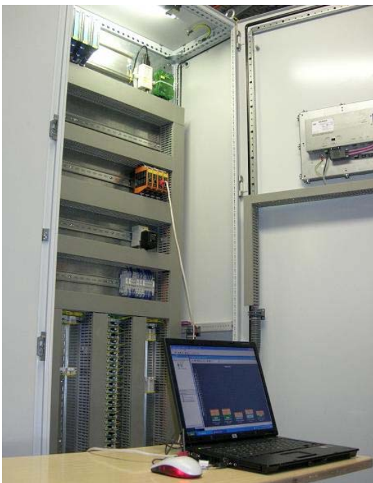
Bild 15: Diagnoseelektronik VSE002 im Einsatz, vor Ort Diagnose via Laptop
