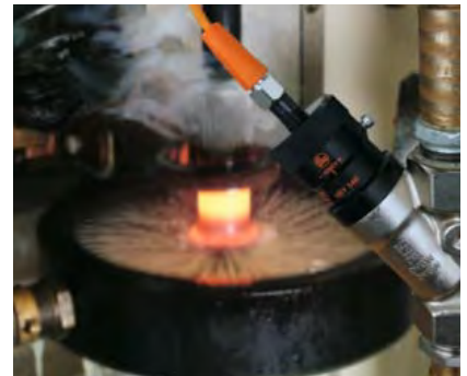
Sensore meccatronico nel circuito dell'acqua di raffreddamento di un forno ad induzione.
