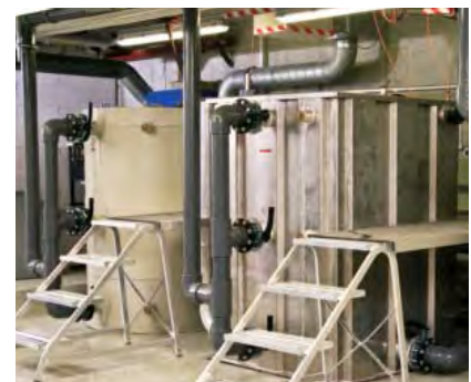
Misurazione del livello in un impianto per il trattamento delle acque.
