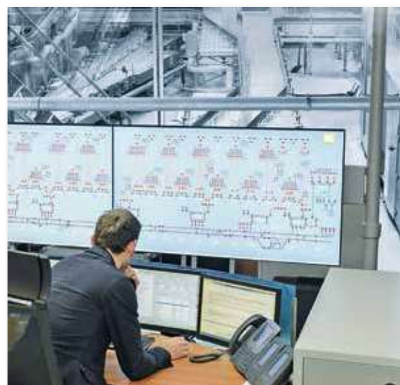
Beispiel: Prozessüberwachung Predictive Maintenance.
