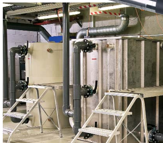
Füllstandmessung in einer Wasseraufbereitungsanlage
