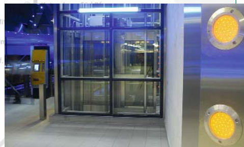
Sämtliche Aufzüge sind an das zentrale Leitsystem angeschlossen.
