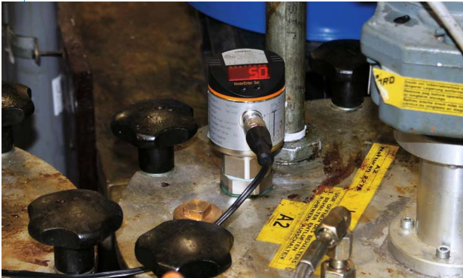
Mikrowellensensor efector gwr detektiert den Füllstand in einem Öltank.
