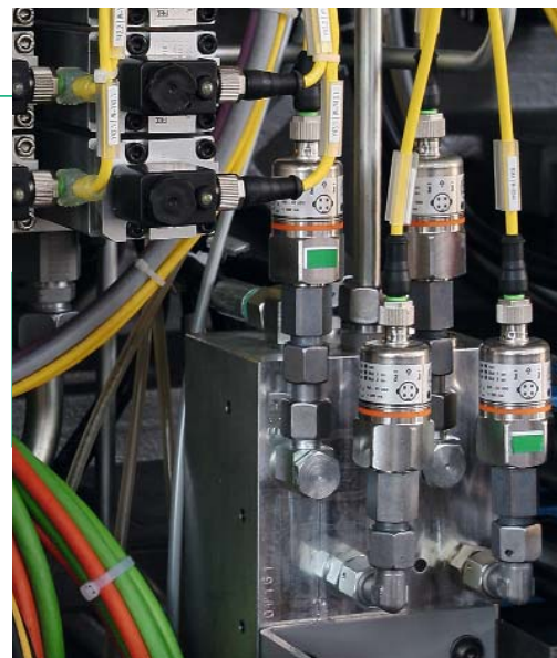
Vier auf der Rückseite platzierte Drucksensoren des Typs PP7552 der ifm electronic überwachen den Spanndruck der Haupt- und Gegenspindel.
