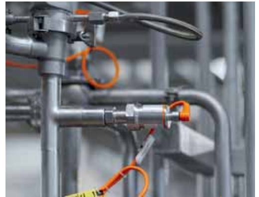
Il sensore di temperatura TAD, senza calibratura, controlla l'uscita di raffreddamento.
