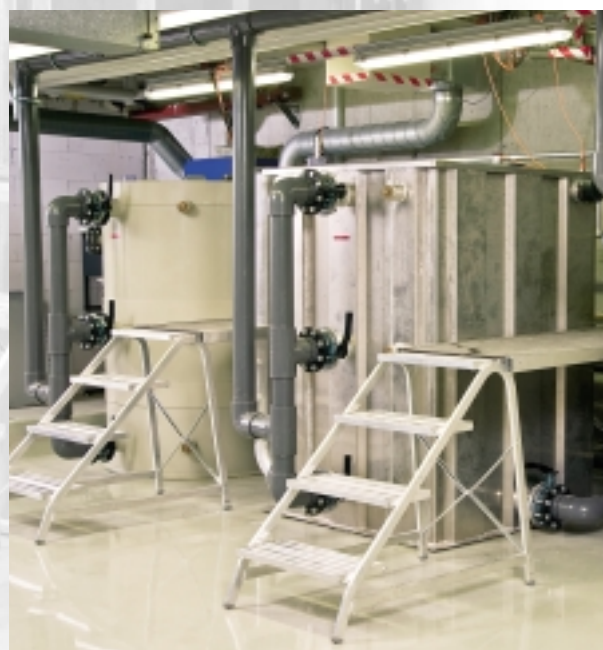
Misurazione del livello in un impianto per il trattamento delle acque
