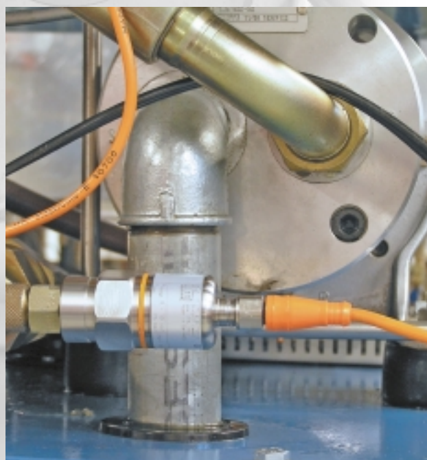
Monitoraggio della pressione nel circuito idraulico.
