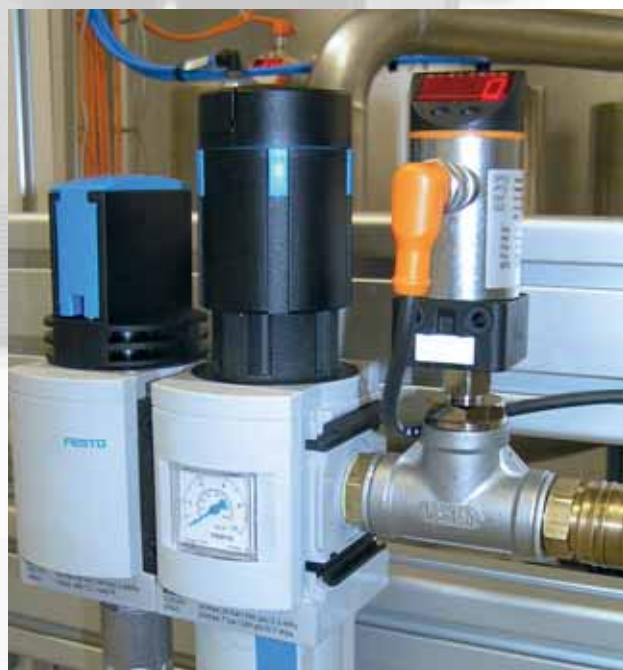
PN78 com acessórios conectado a uma unidade de manutenção do sistema pneumático
